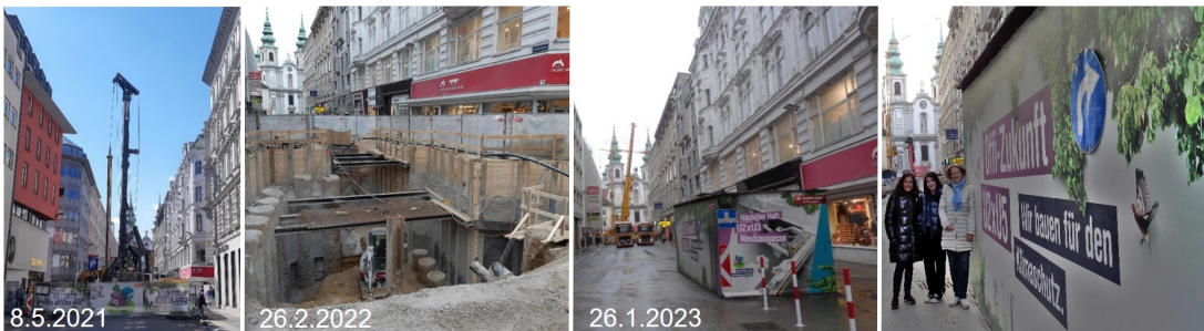
Veränderungen der Baustelle des neuen Stationsbauwerkes „Neubaugasse“ der U2-Süd-Verlängerung im Kreuzungsbereich Kirchen-/Lindengasse: Es begann Anfang 2021 mit der Bohrpfahlherstellung und bereits ab Anfang 2023 erfolgten die Bauarbeiten unter der Erde. Sukzessive wird bis ca. 35 m unter Gelände abgetieft. Die Eröffnung der U2-Süd ist für 2028 geplant (Fotos mit Blickrichtung nach Süden, zur Mariahilfer Kirche; Container: Einstieg in den Untergrund).
